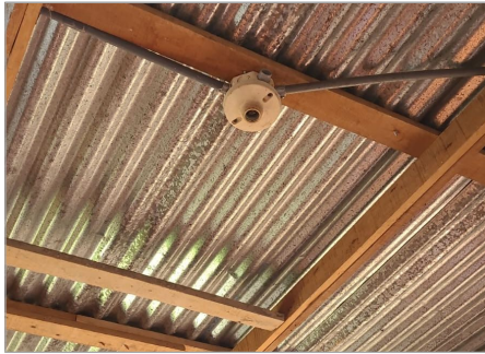
Instalación eléctrica entubada
