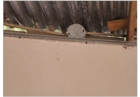
Instalación eléctrica entubada
