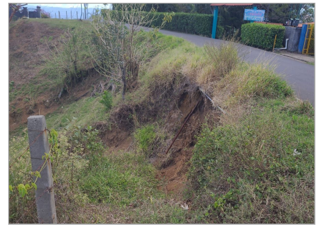
Terreno con deslizamiento de tierra
