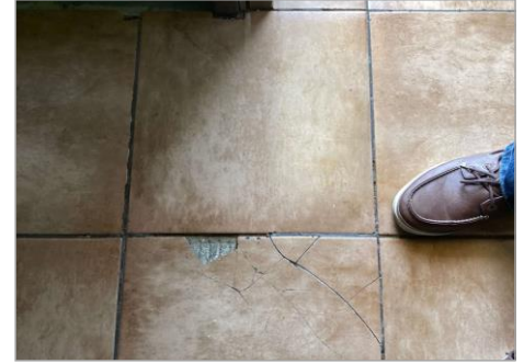
FISURAS EN PISO
