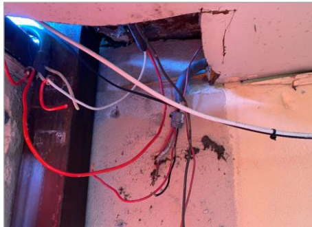
INSTALACION ELECTRICA MAL ESTADO
