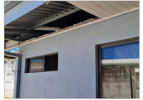
Otro sector de cielos desprendidos.
