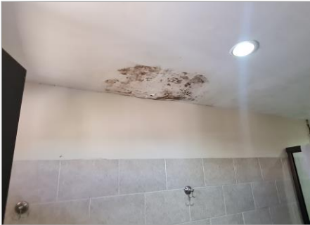
Humedad en cielo de baños.
