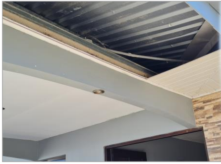
Sector de cielos en aleros desprendidos.
