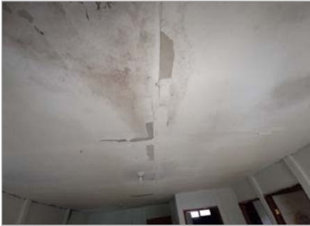
DETERIORO EN CIELO RASO
