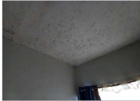
DETERIORO EN CIELO RASO
