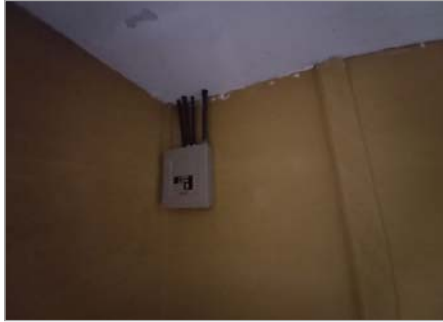
CAJA DE BREAKERS
