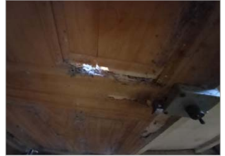
DETERIORO PUERTA PRINCIPAL
