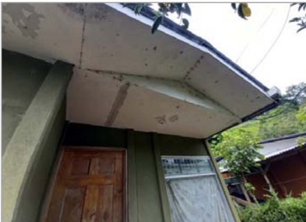
DETERIORO EN ALEROS
