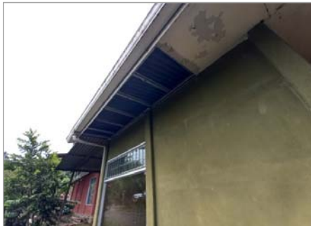
DETERIORO EN ALEROS
