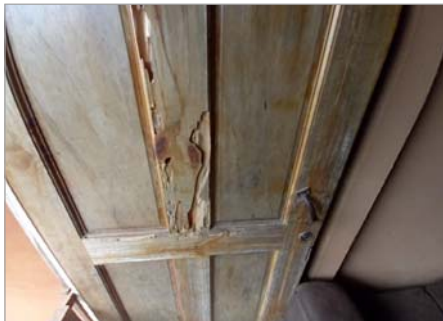
DETERIORO PUERTA PRINCIPAL
