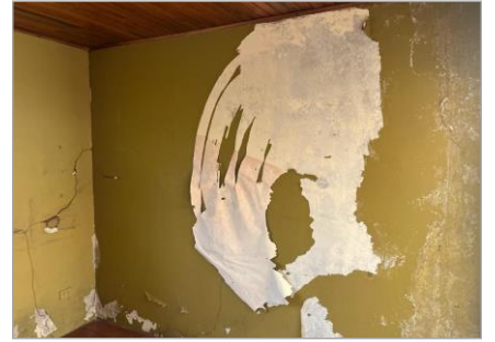
DAÑO EN PINTURA
