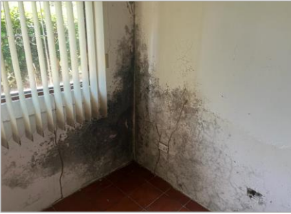
DAÑO EN PAREDES
