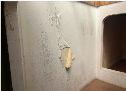
DAÑO EN PINTURA
