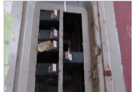
Caja de breakers
