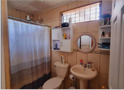
Servicio Sanitario dormitorio principal
