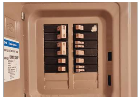
Caja de interruptores
