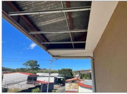
DAÑO EN CIELO RASO
