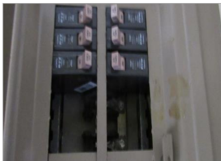
Caja de breakers
