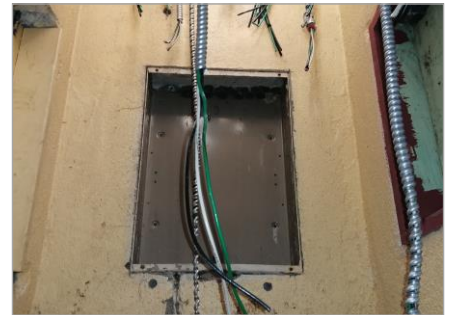
CAJA DE BREAKER
