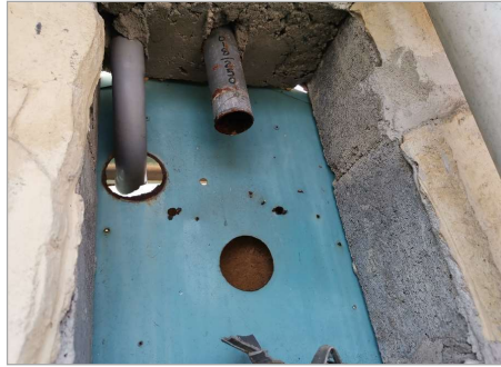
Foto 26. Centro de carga desmantelado
