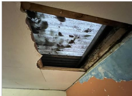
Cielo raso con deterioro
