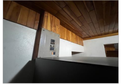
Centro de carga
