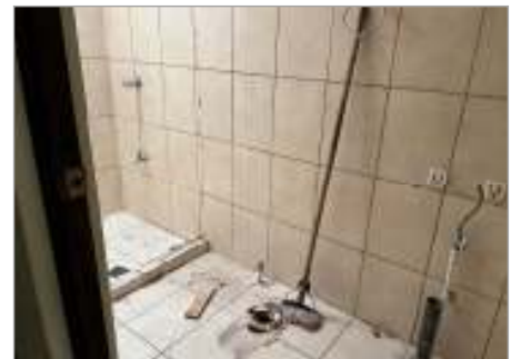
Baño completo (vandalizado)
