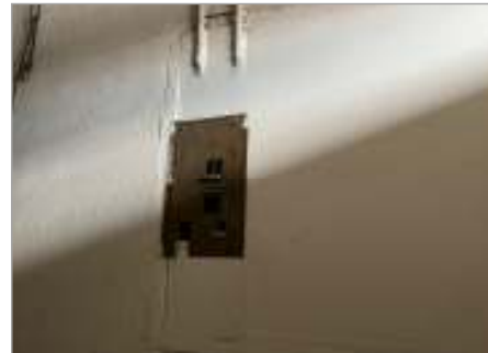
Caja de breakers
