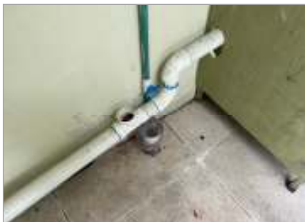
Tubería en local comercial
