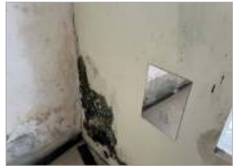
Pared con humedad
