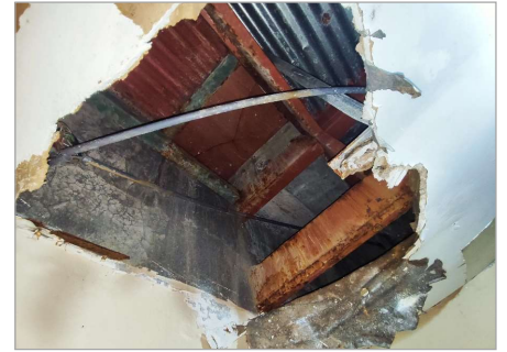
Cielo dañado en área cocina vivienda
