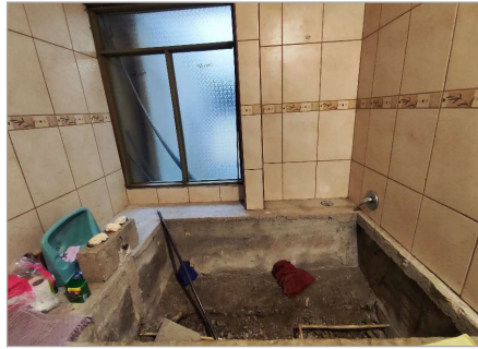
Faltante piezas sanitarias
