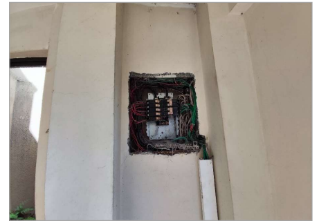
Conexión eléctrica mal estado
