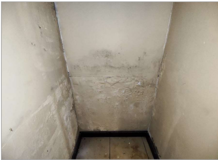
Daño en cielos paredes III Nivel
