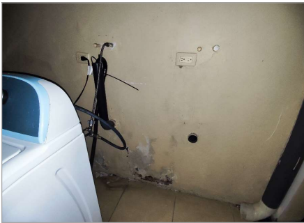
Humedad en pared de lavandería
