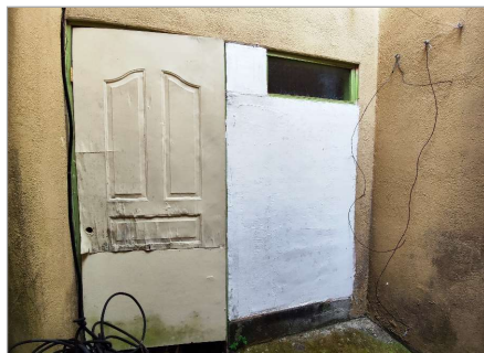
Humedad en cuarto de luz y puerta mal estado
