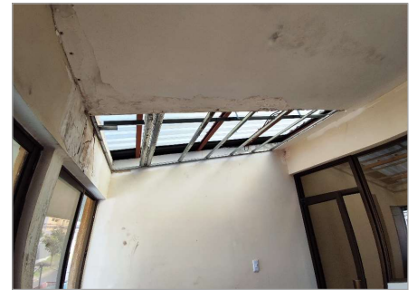
Daño en cielos paredes II Nivel
