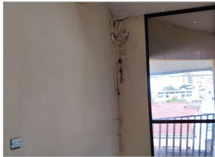
Daño en paredes II Nivel
