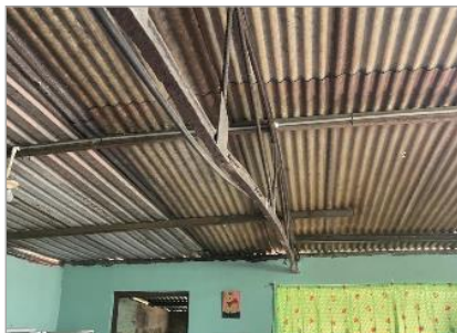
Detalle de cerchas con problemas de pandeo
