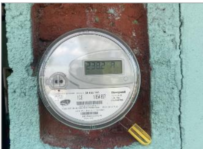
Detalle medidor electrico
