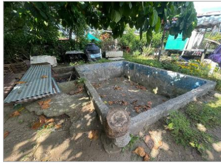
Espacio de pileta sin uso y en mal estado
