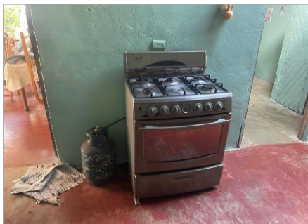
Cilindro de gas dentro de la construccion
