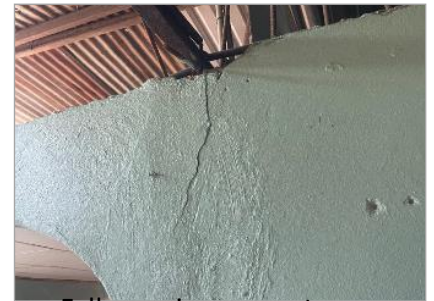
Falla en viga en punto apoyo techo
