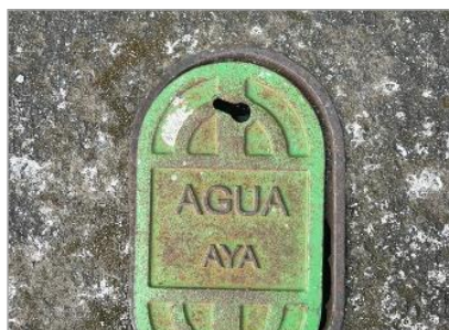
Detalle medidor agua potable
