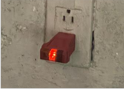
Prueba sistema electrico, sin aterrizar
