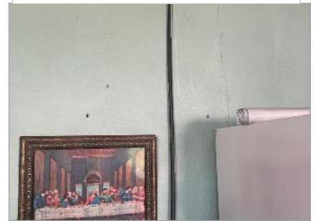
Tubos sin fijar a la pared
