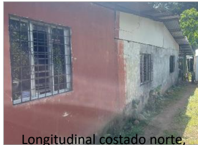
Longitudinal costado norte, problemas del alero, tapichel fibrocemento regular estado
