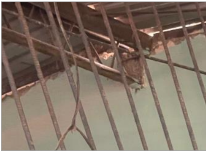
Detalle exposiciones de cables
