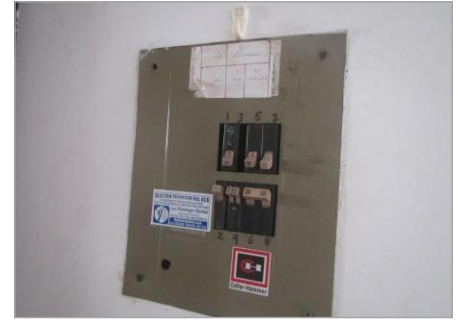
Caja de breakers
