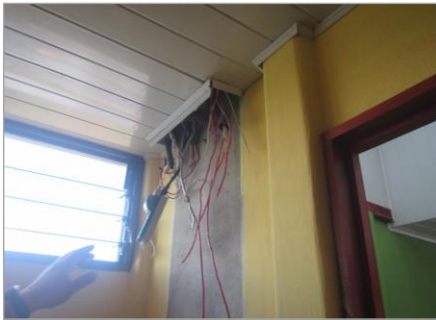
Sin caja de breakers
