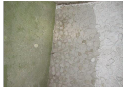
Deficiencias Observadas: Filtraciones de Humedad (Casa)
