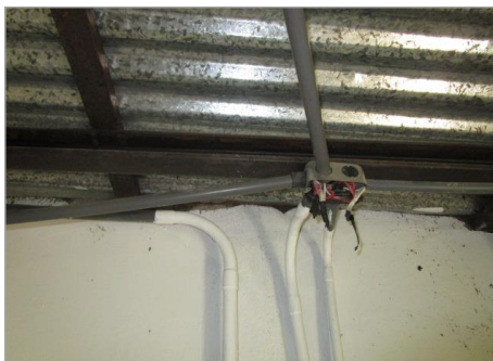
Deficiencias Observadas: Sist. Eléct. (Cajas sin tapas)
