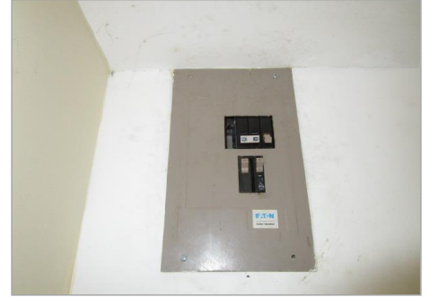
Caja de Breakers
