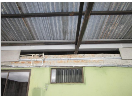
Deficiencias Observadas: Sección Faltante
