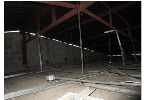
Sistema Eléctrico / Cajas sin Tapas
