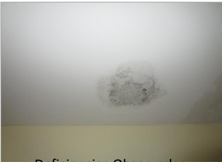
Deficiencias Observadas: Filtraciones de Humedad (Casa)
