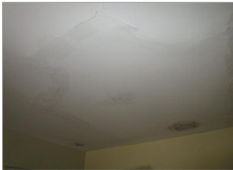
Deficiencias Observadas: Filtraciones de Humedad (Casa)
