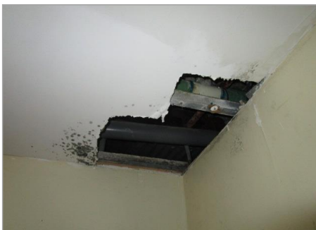
Deficiencias: Filtraciones de Humedad (Apart.)
