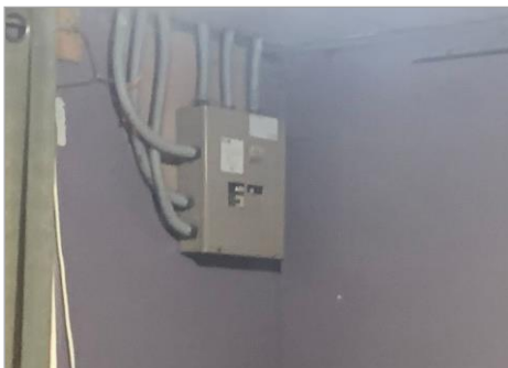
Centro de carga
