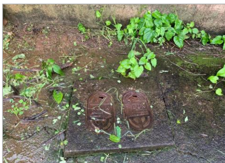
Medidor de agua potable
