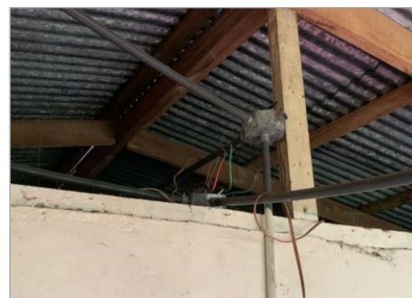
Instalación eléctrica expuesta
