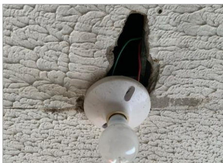
Instalación eléctrica expuesta
