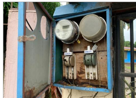
Medidor de fluido eléctrico
