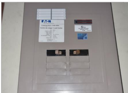
Caja de Breakers
