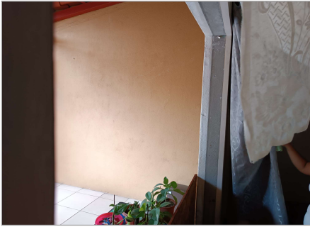
Buque sin puerta de vidrio
