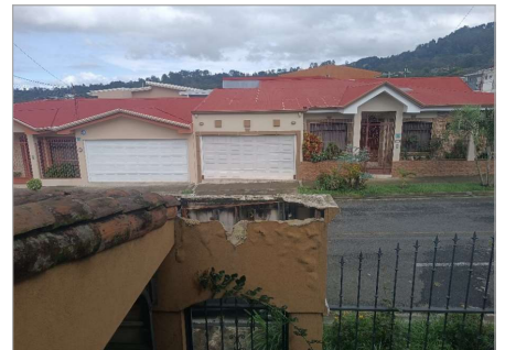
Estructura liviana fachada dañada
