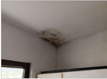
Filtraciones en cielos
