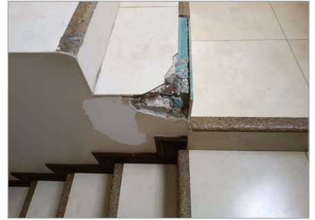
Daños en gradas
