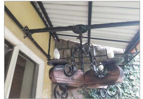
Empalme y cables de lámparas expuestos
