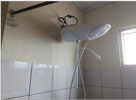
Instalación de duchas con cables expuestos
