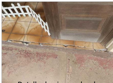
Detalle de piso quebrado saliendo del comedor al patio
