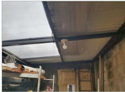
Instalación expuesta en paso cubierto y bodega
