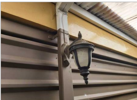
Empalme y cables de lámparas expuestos
