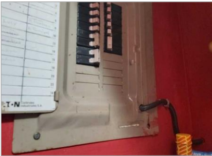
Centro de carga con circuito mal conectado
