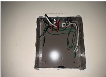
Caja de breakers, sin cables ni breakers
