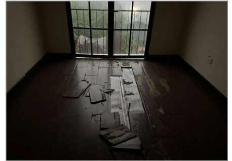
Piso laminado en 2º nivel, en mal estado
