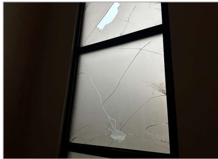
Vidrios en fachada principal, quebrados
