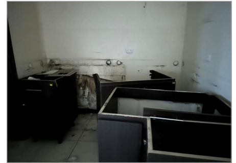
Cocina, muebles destruidos, sin fregadero
