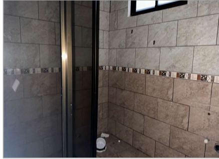
Baño 1º nivel, sin loza sanitaria
