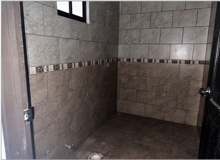
Baño 2 en 2º nivel, sin loza sanitaria
