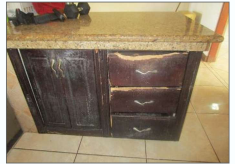
Gavetas de mueble de cocina dañadas
