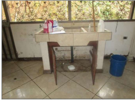
Falta de sifón en pila
