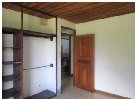
Dormitorio, closet desmantelado
