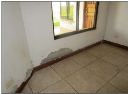
Paredes falta de pintura
