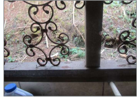
Rejas metálicas herrumbadas
