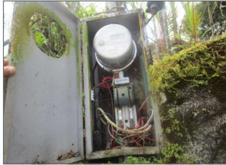
Vista del medidor de corriente con su respectiva cuchilla
