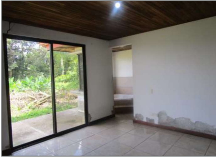
Área de sala, falta de pintura
