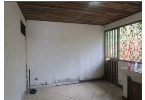
Área de pilas, falta de pintura
