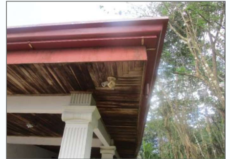
Ceilo raso dañado
