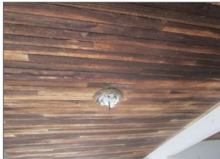
Faltan plafones en área de corredor
