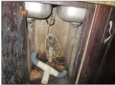
Desague de fregadero dañado
