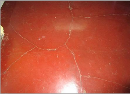
Piso lujado de cocina fisurado
