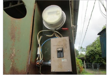
Vista del medidor de corriente
