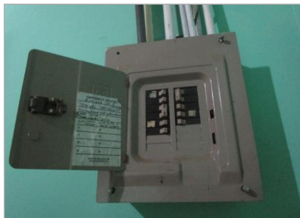
Caja de breakers
