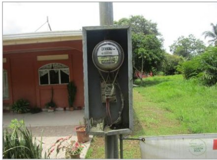
Vista de medidor de corriente
