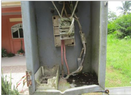
vista de vista de medidor de corriente
