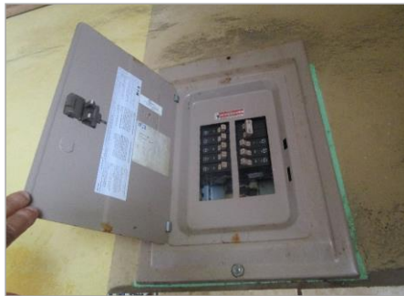
Caja de breakers
