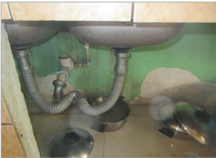
Falta de sifones en fregadero
