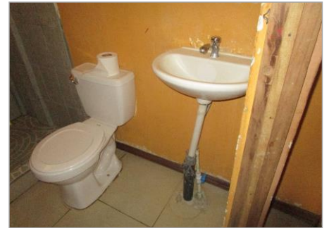
Área de servicio sanitario, lavatorio sin sifón
