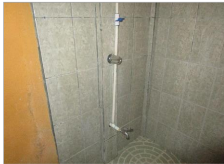
Tubería de ducha expuesta, no empotrada
