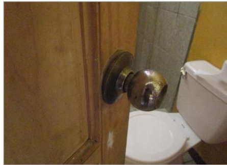
Llavin en mal estado
