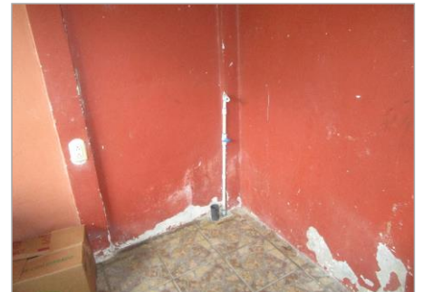
Falta pila de lavado
