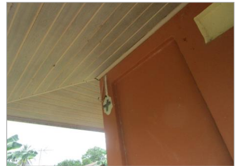
Falta de lámparas
