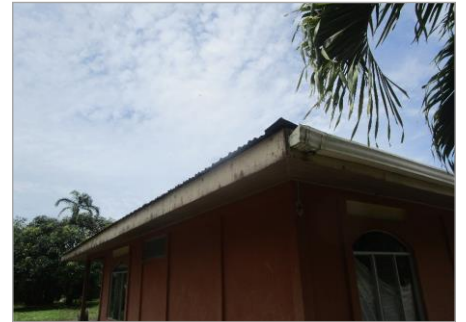
Falta canoas y bajantes
