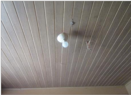
Cielo raso de un dormitorio, se observa plafón desprendida y cable sueltos a la par
