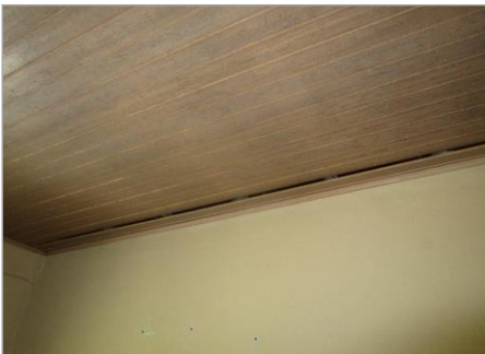
Cuarto redondo desprendiendose
