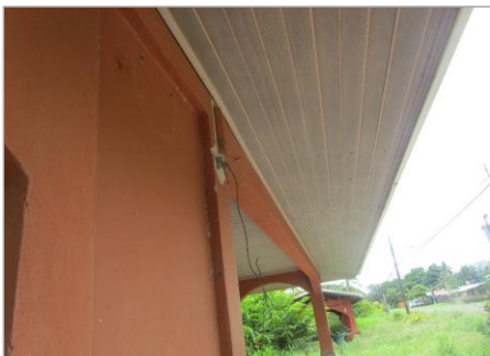
Falta de lámparas
