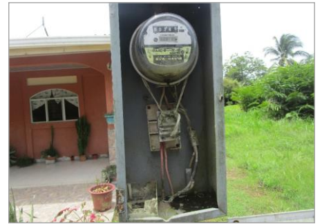
Vista de medidor de corriente
