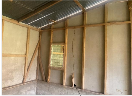
Pilas. Se ven piezas dañadas
