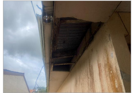
Alero en mal estado
