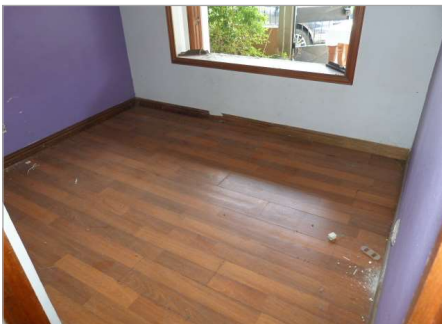
Dormitorio, faltan ventanas
