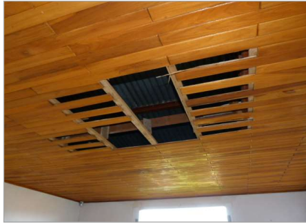
Daños en cielo raso tablilla sala comedor
