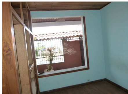
Dormitorio, faltan ventanas
