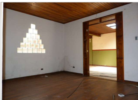
Dormitorio, faltan puertas internas
