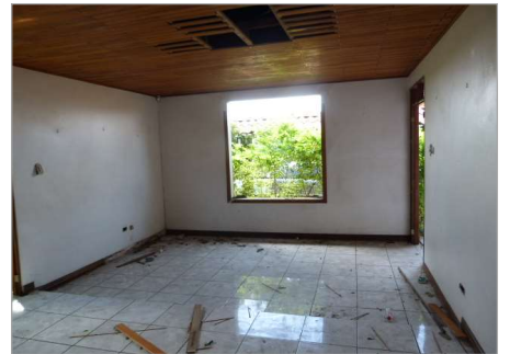
Sala Comedor, faltan ventanas y puertas
