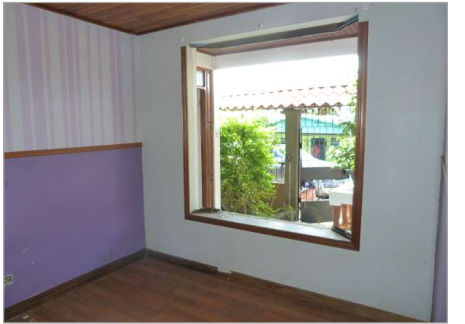
Faltan ventanas en dormitorio
