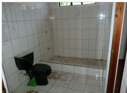
Dormitorio, falta lavatorio
