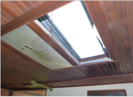
Daños en cubierta techo y cielo raso
