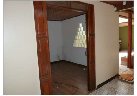
Faltan puerta en dormitorio
