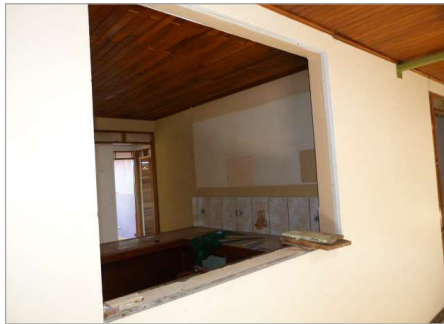
Faltan ventanas en cocina
