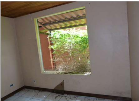
Faltan ventanas en dormitorios
