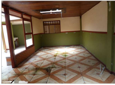
Terraza, faltan ventanas
