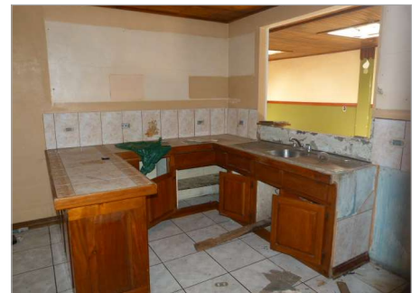
Cocina, faltan ventanas
