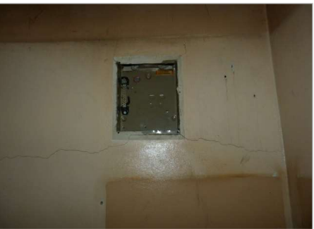
Caja de breaker sin disyuntores
