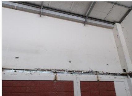
Paredes en anexo oficina
