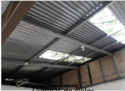
Láminas de cielos faltantes en oficinas posterior
