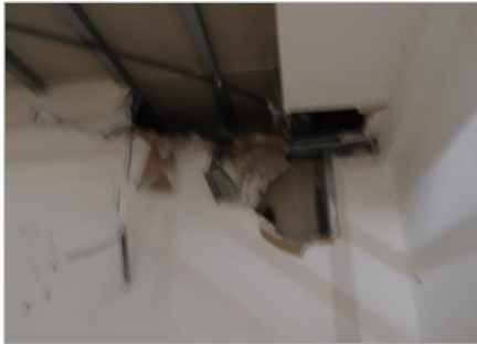
Daños en tapichel de muro seco
