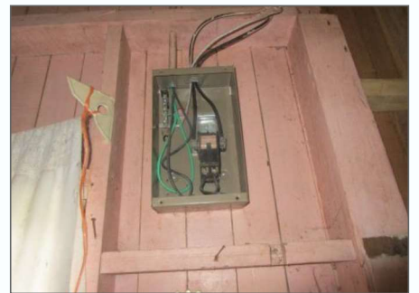
Vista de otra caja de breakers
