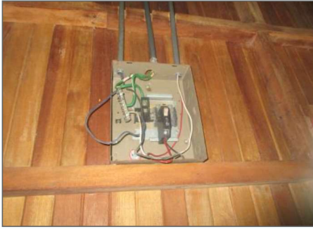
Caja de breakers
