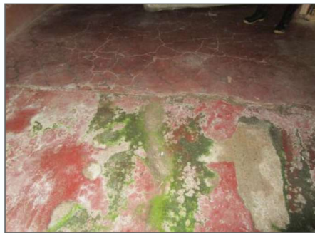
Vista de piso luja, reventado y con moho
