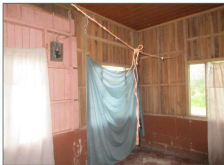
Vista de caja de breakers
