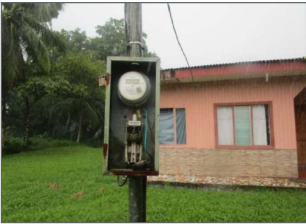
Vista del medidor de corriente y su respectiva cuchilla
