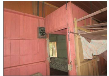
Vista de caja de breakers
